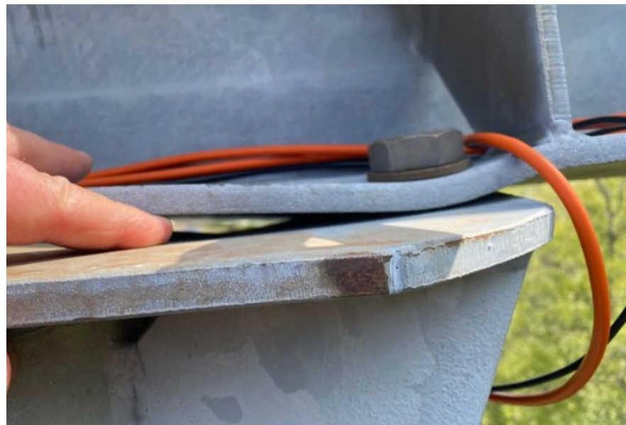
Figur 8: Typisk frostskeide som ein finn i 4 av mastene. Flatene skulle ligge tett på kvarandre, men både mast og traversbjelke er sterkt deformerte.
